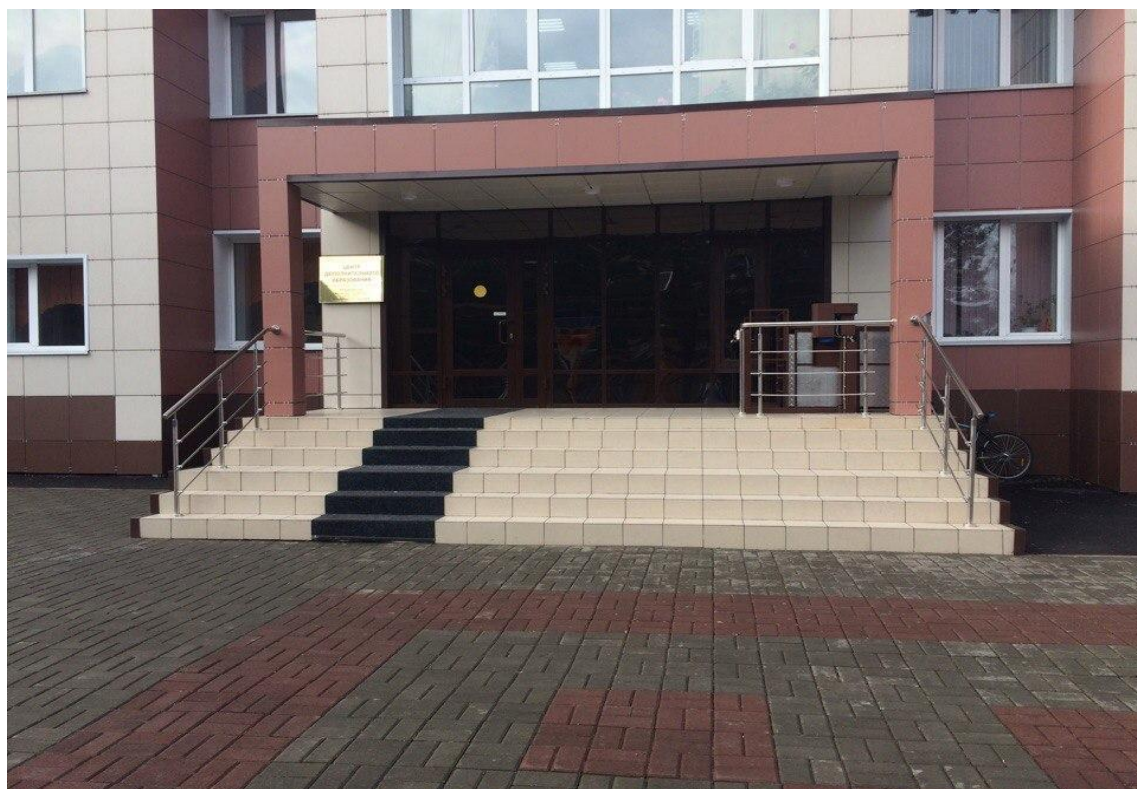
Фото 4 Пандус (наружный), колясочный подъемник
